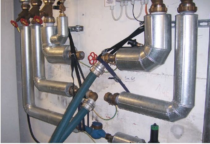
Drucklufteinspeisung über Adapter.
